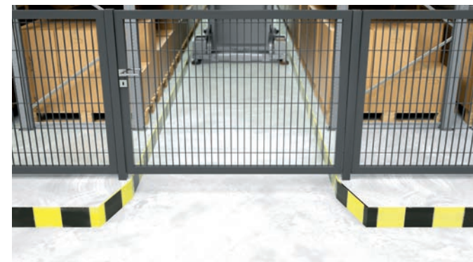
Stationäre Personenschutzanlage mit kompletter Bereichsabsicherung
