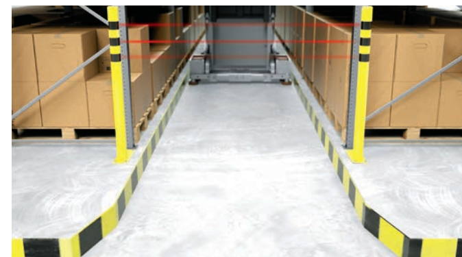
Stationäre Personenschutzanlage mit Lichtschranken in ausgewählten Regalgängen
